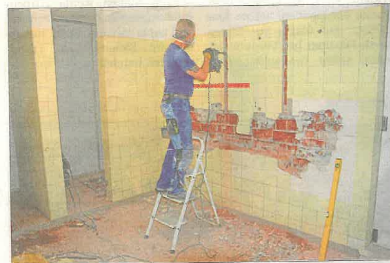
Staubhaltig war die Luft gestern in der Damendusche des Alzstadions. Hier wurde mit dem Abstemmen der Wandfliesen begonnen.
